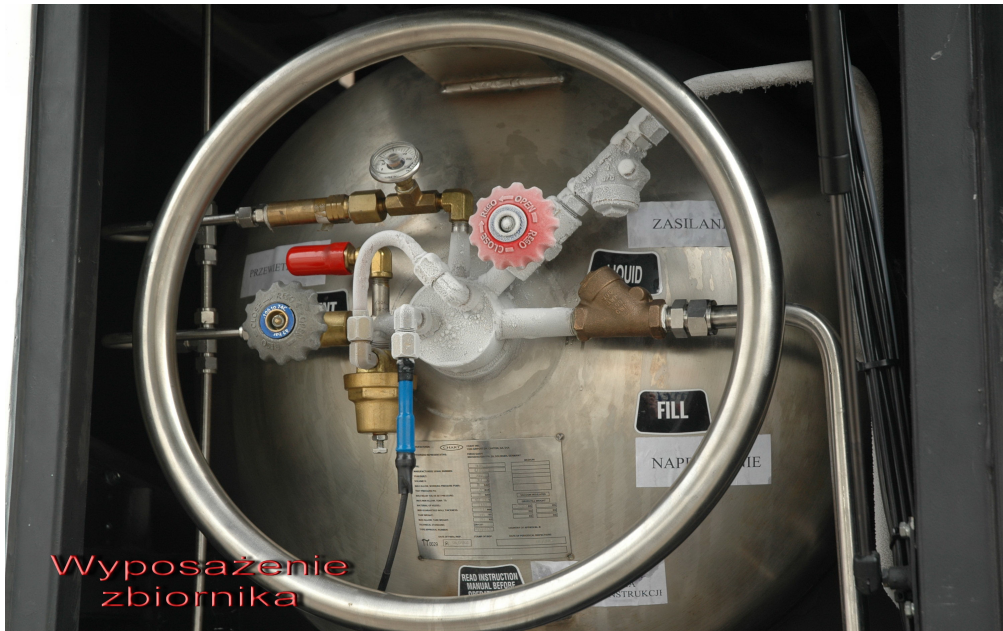
Fot. 4. Kriogeniczny zbiornik metanu LNG zamontowany w autobusie SOLBUS
